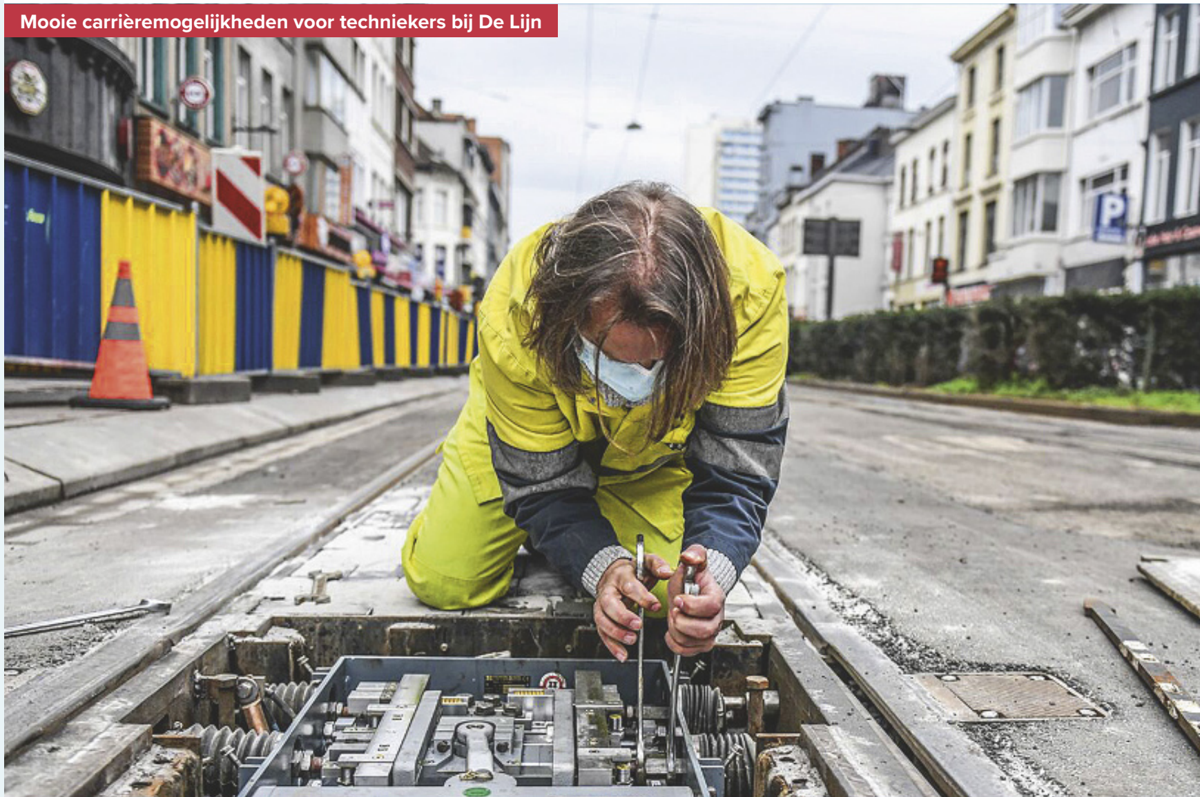
Tramtechnieker Roy ontfermt zich samen met zijn collega over de seinen, wisselsturingen en bovenleidingen in de stad.
